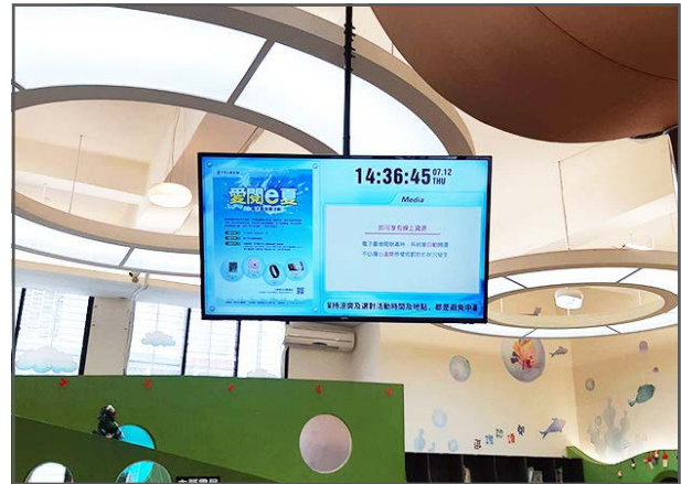
教育機構數位看板 - 臺中市立圖書館-北屯分館 /臺灣
